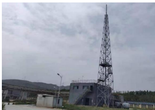
危险废物焚烧装置排气筒
