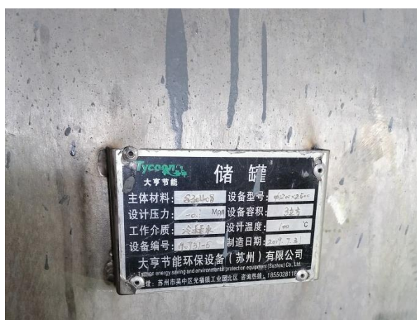
冷凝水回收储罐
