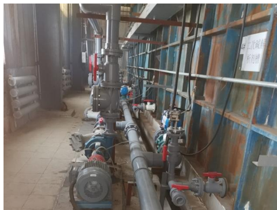
吸附余液及洗水收集输送管道
