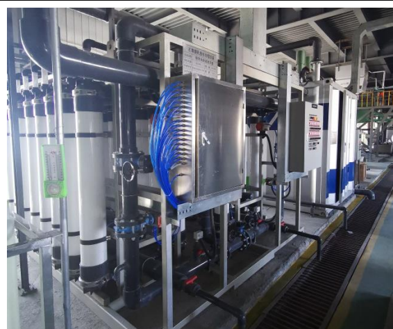
吸附余液处置超滤装置
